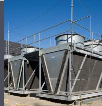
Kaltwasser und Kühlsohle
